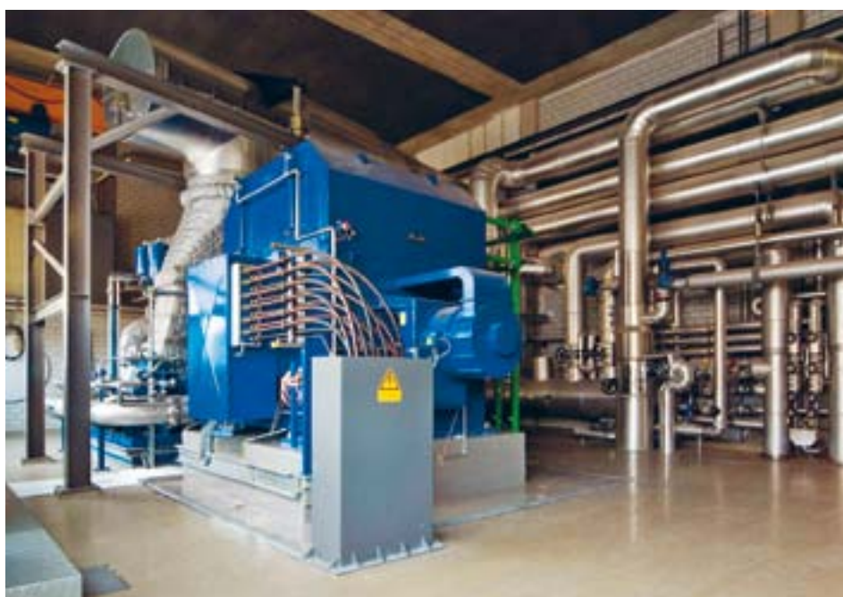
In der KVA Thurgau wird auch Energie produziert. Mit der neuen Dampfturbine (im Bild) kann 20 Prozent mehr Strom erzeugt werden.
